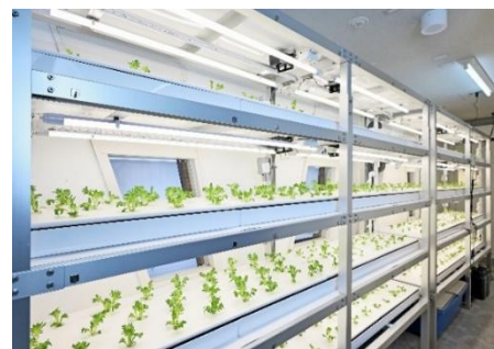
プラントルーム (水耕栽培設備室) ※3
